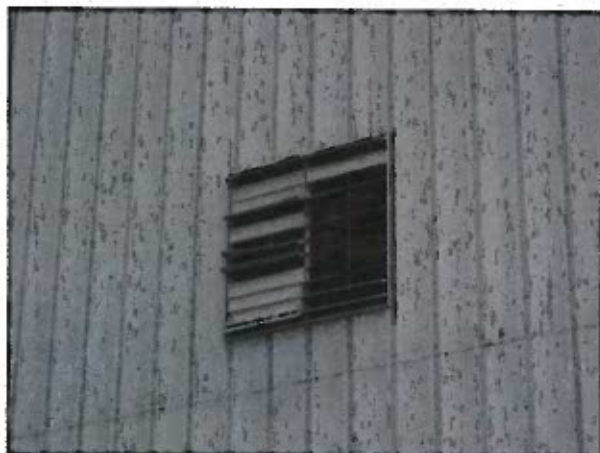
Fan Louver Damage @ EGA 3
